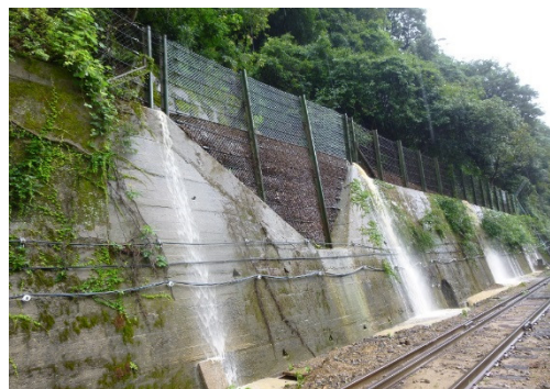
トロッコ保津峡駅～トロッコ亀岡駅間 (7k800m 土砂流入)
